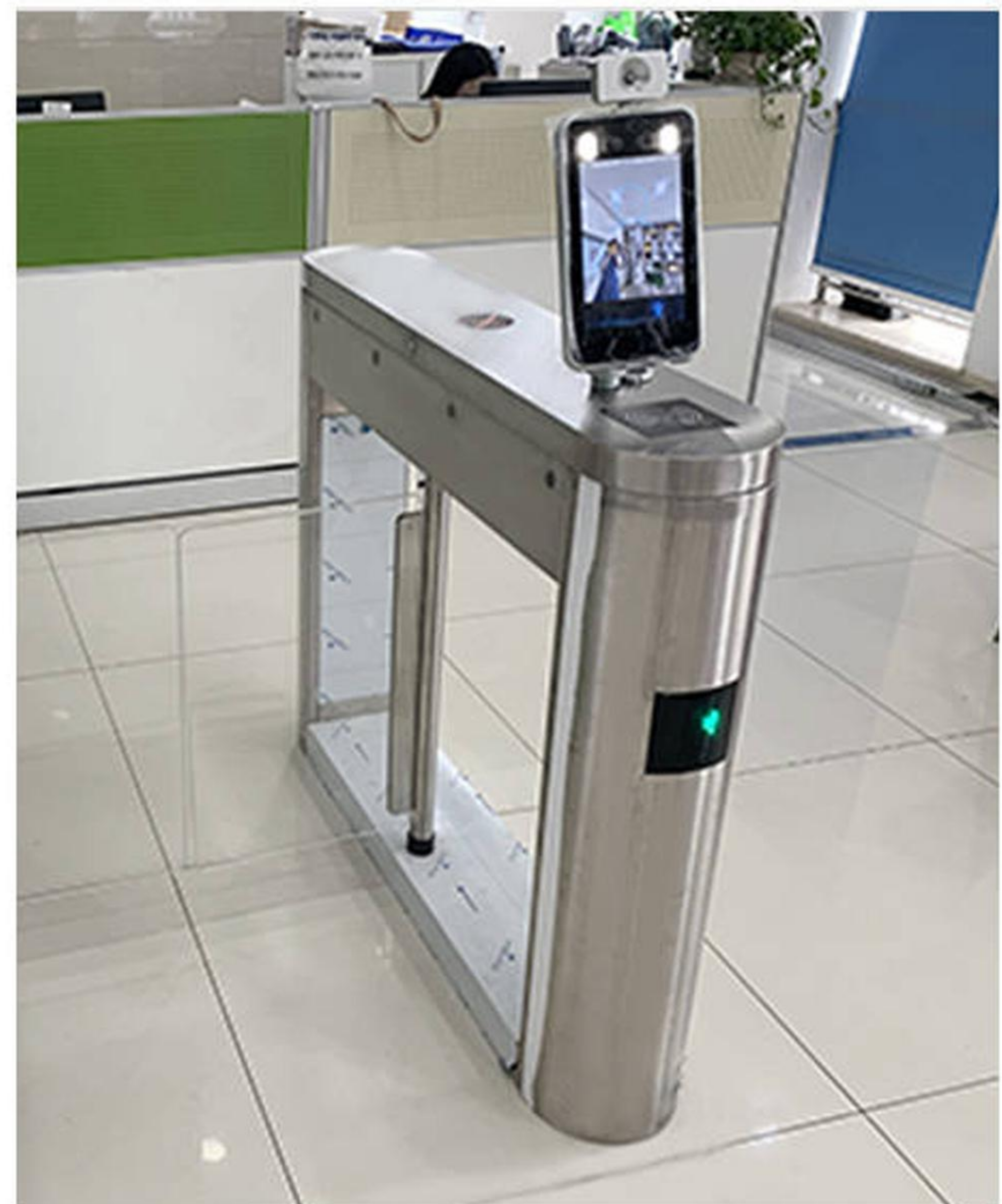
نصب بر روی پایه گیت های موجود
